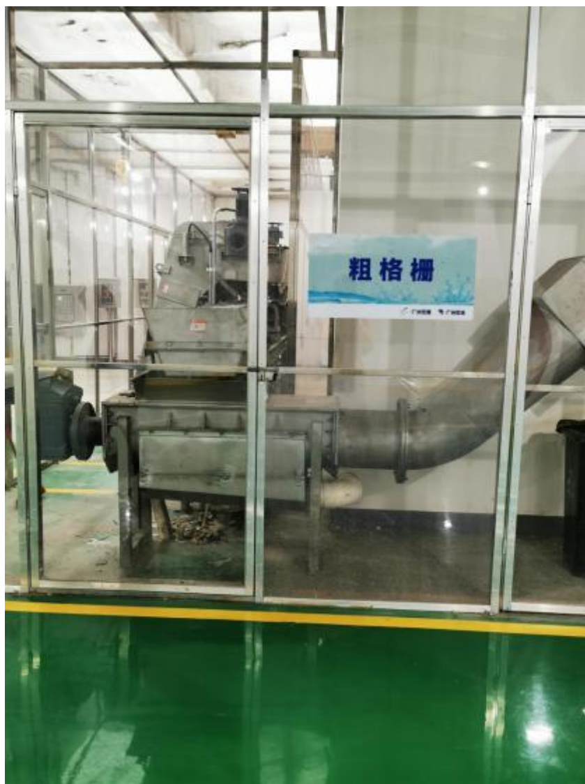
图 3.9-4（3） 同类工程-广州花东污水厂同种收集方式（全密闭）格栅间照片 则可计算本项目建成后，恶臭的污染物的产生及排放量，详见表 3.9-12。
