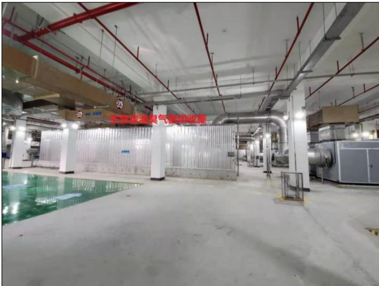
图 3.9-4（1） 同类工程-广州花东污水厂废气处理装置（密闭加盖生物滤池）照片
