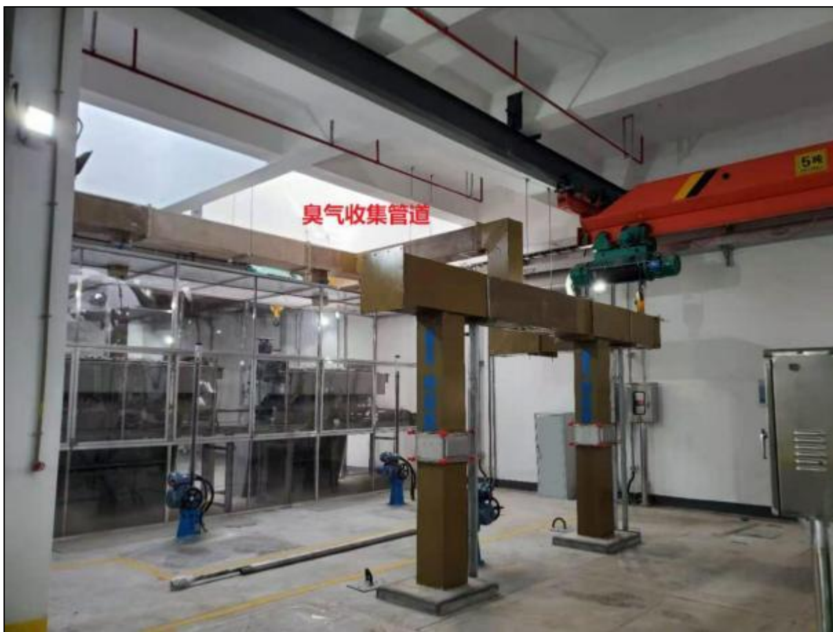
图 3.9-4（2） 同类工程-广州花东污水厂全密闭收集照片
